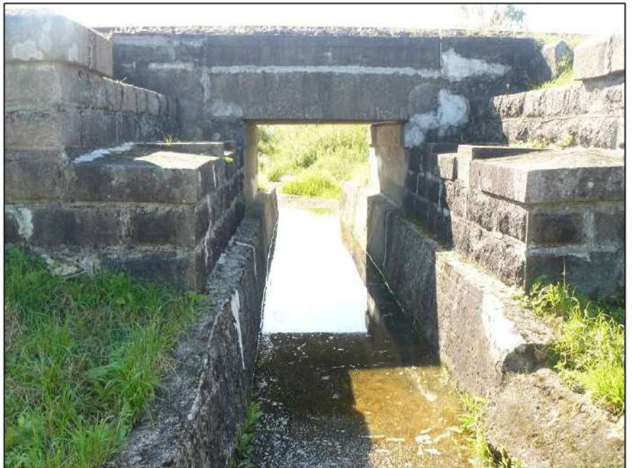
Nuotrauka Nr.1. Tiltu vaizdas iš šiaurinės geležinkelio pusės. Matyti plyšių užtaisymai cementiniais mišiniais, templė (viršutiniame dešiniame nuotraukos kampe), nubėgimo latakų borto trūkiai ir poslinkiai (apatiname dešiniame nuotraukos kampe). Po tilto latakų esanti pralaida užlieta vandeniu.
